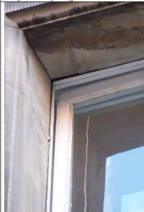
11. Niedomknięte skrzydło z powodu niesprawnego dawnego systemu zamykania.
