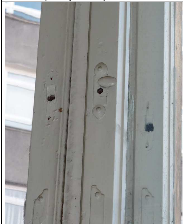
7. Sztyldziki w górnych skrzydłach. Widoczne braki.
