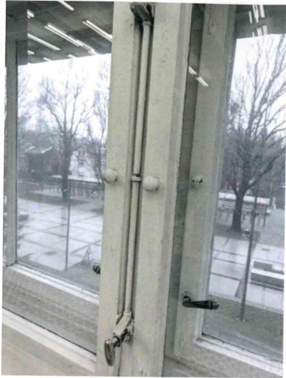
fot. 4 Widoczne oryginalne okucia okienne okien: zawrotnica, gałki, klamki typu L.
